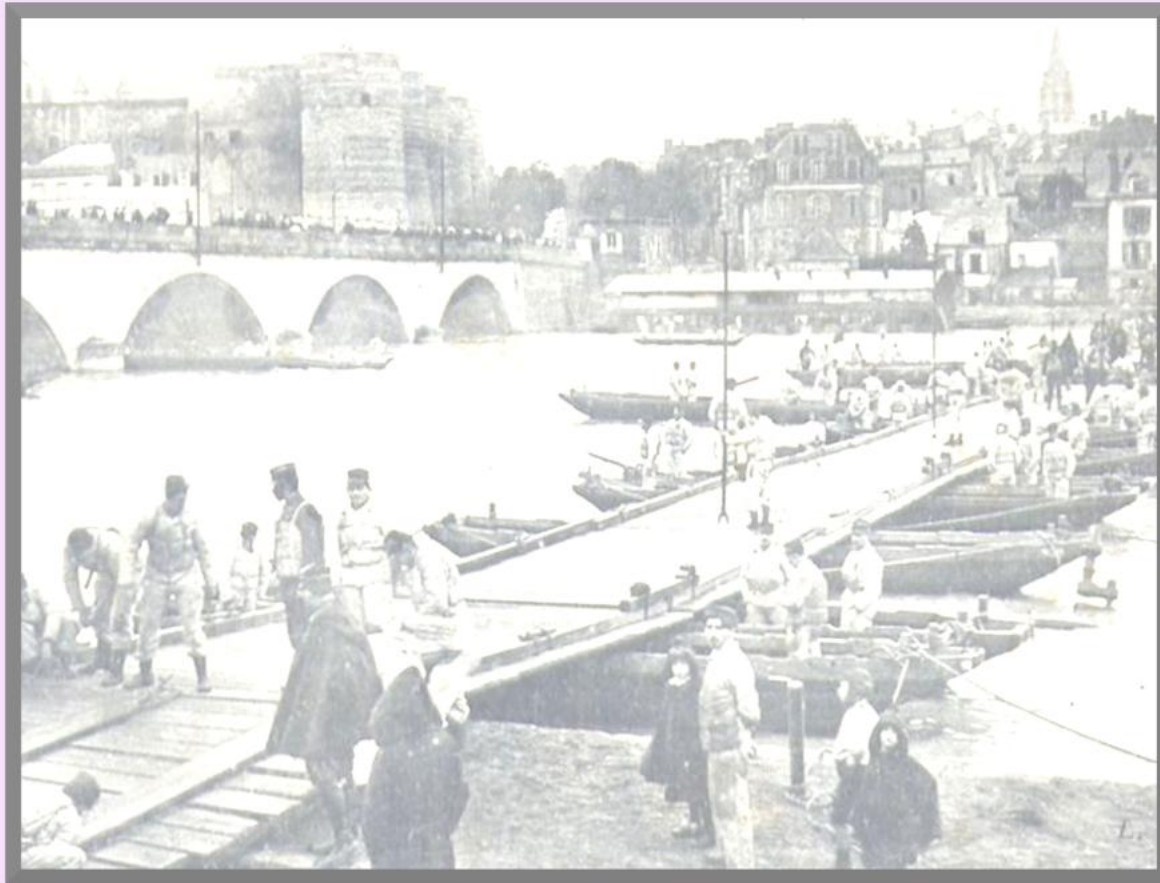
A Angers, Construction d'un pont sur la Maine par le 6 e génie. Carte postale. Collection particulière.
